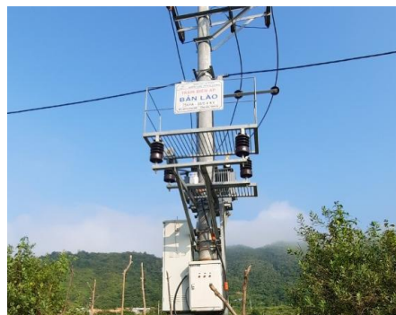
Trạm biến áp tại bản Lào
