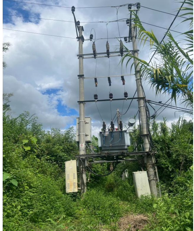
Trạm biến áp
