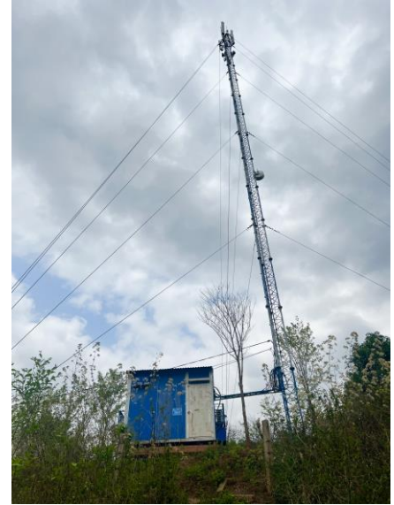
Hình 21: Trạm BTS Vinaphone
