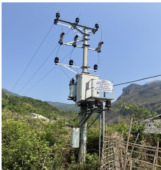
Hình 19: Trạm biến áp
