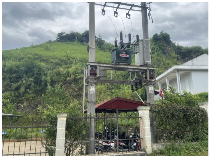
Trạm biến áp
