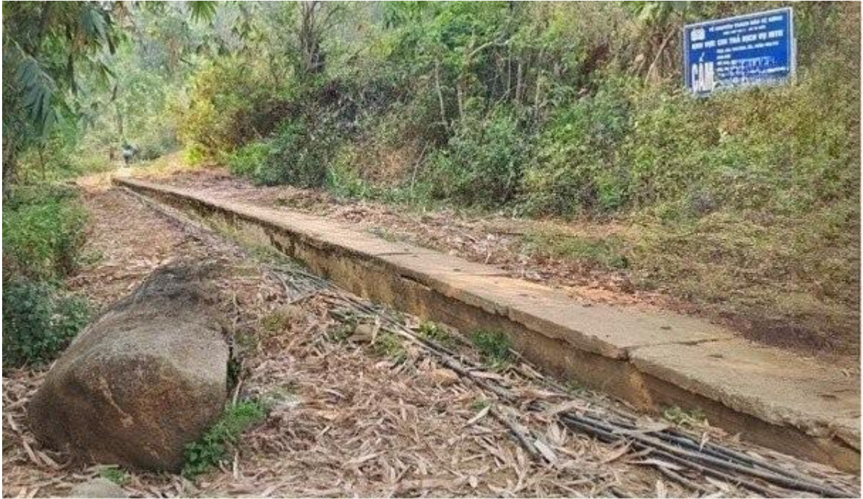
Hình 8: Hệ thống kênh mương đã được kiên cố hóa
