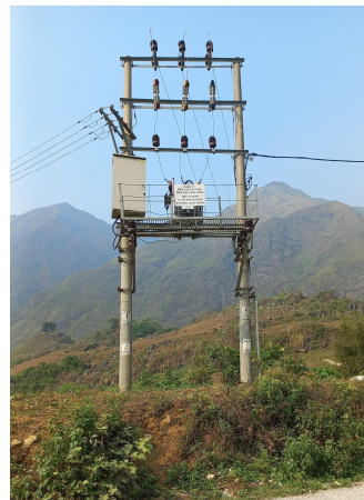
Hình 8: Trạm biến áp
