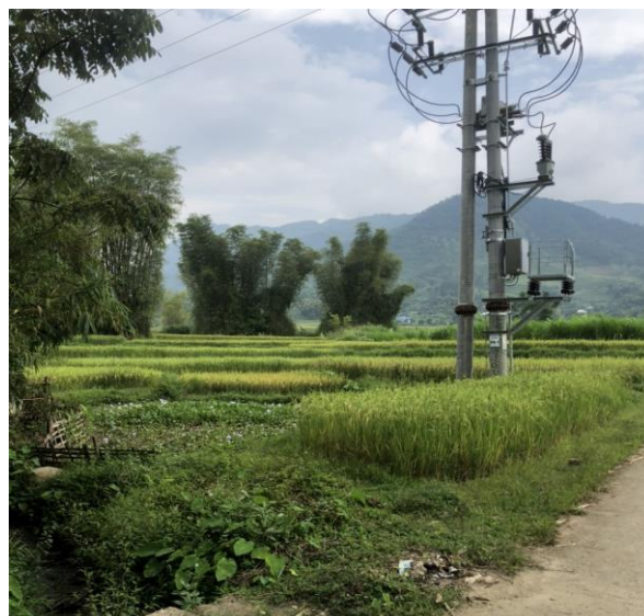
Trạm biến áp
