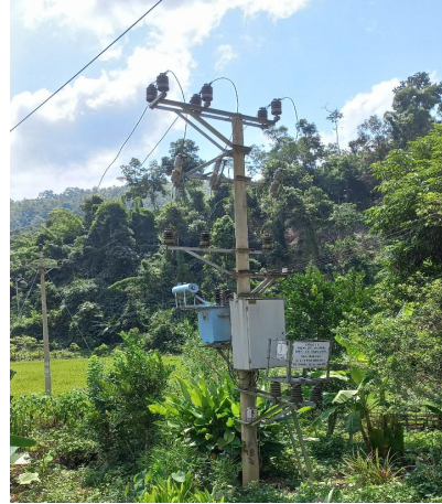
Trạm biến áp
